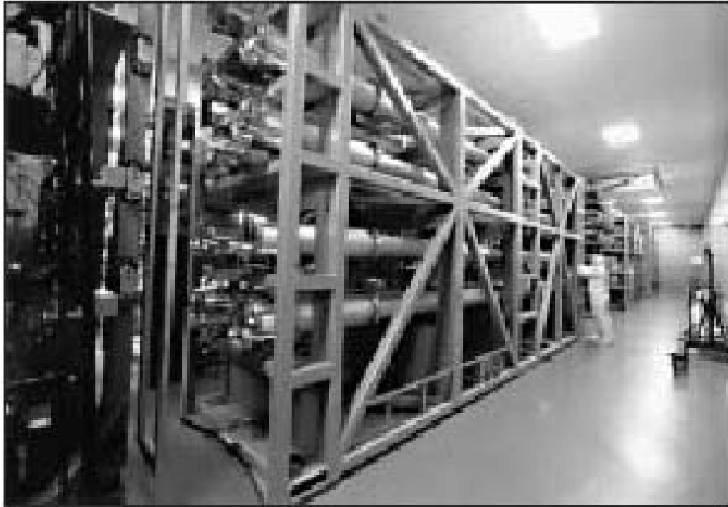
Рис. 1.5.5. Установка «Омега» Внутренний вид зала с усилителями
